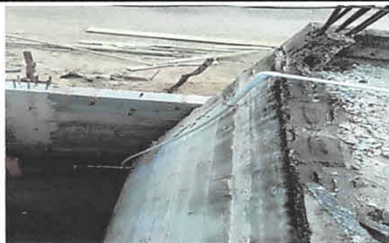
FOTO 4: TUBERIA DE AGUA POTABLE
